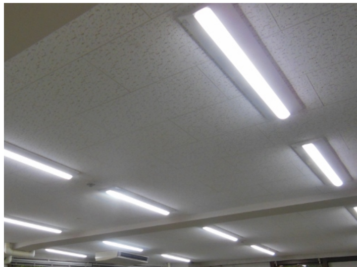
生物実験室…先週蛍光灯からの交換がすべて終了しました。 こちらも20日をご覧ください!
